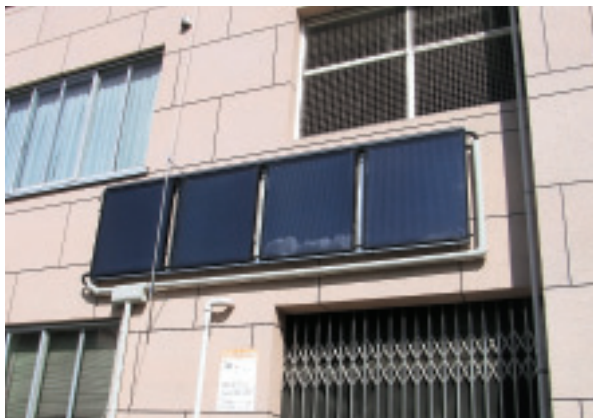
写真4-15-2 県庁舎の太陽熱給湯設備
